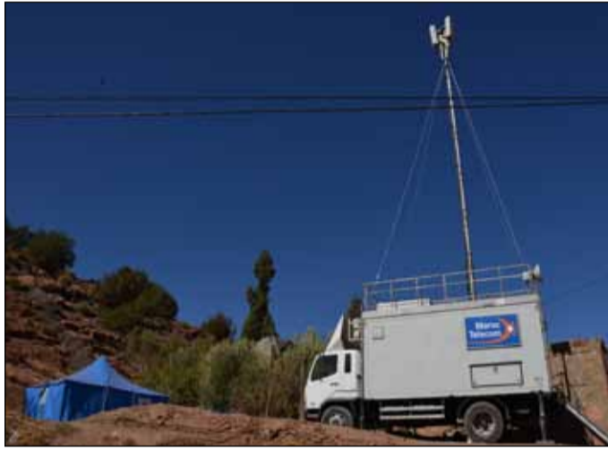
Un dispositif de télécommunication mobile déployé par Maroc Telecom dans les zones sinistrées.
