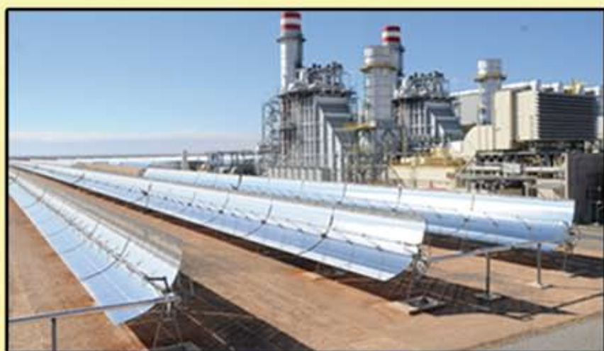
Centrale Thermo Solaire d'Ain Béni Mathar
